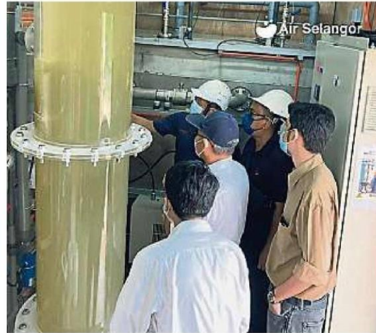
和双溪拉骚湖生水。（照片取自雪州水务管理公司脸书） 雪州水务管理公司采用臭氧系统来过滤巴生河
